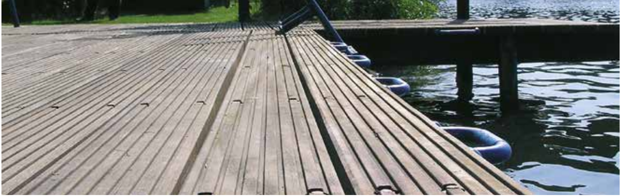
Unterkonstruktion im Wasser: Anwendungsbeispiel für Bongossi-Kantholz
